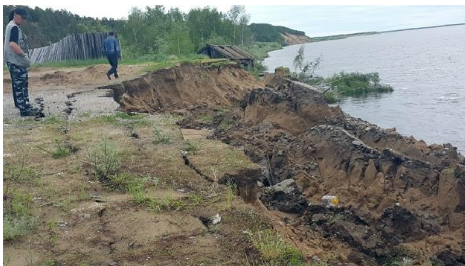
Рисунок 1 – Разрушение береговой линии в районе Затона г. Саратова
